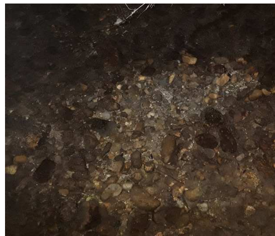
Figure 12 : zone grattée dans un radier
