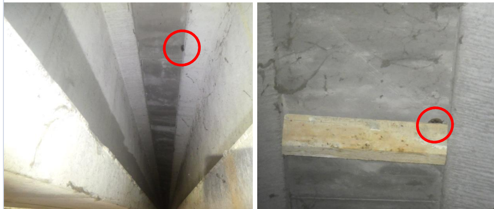
Murin de Daubenton contre la paroi d'une poutre sous le tablier -- Murin indéterminé entre planchette et tablier
