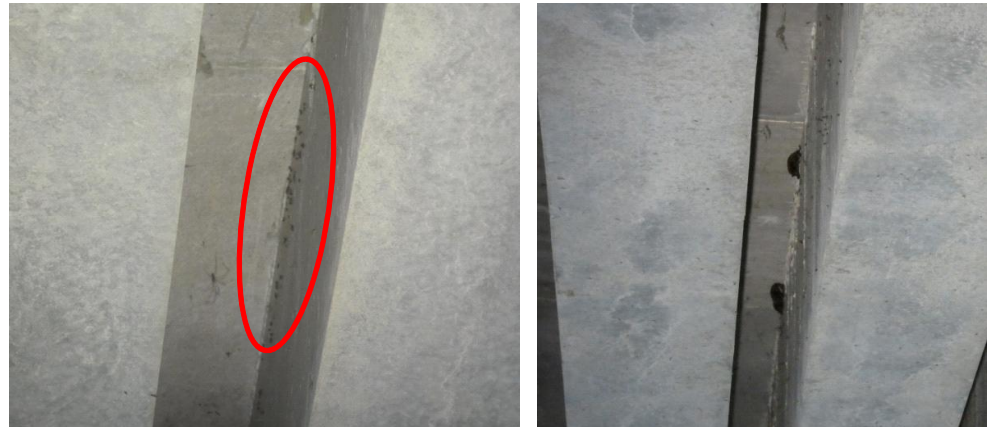
Guano accroché aux parois des poutres sous le tablier -- 3 chauves-souris accrochées aux parois
