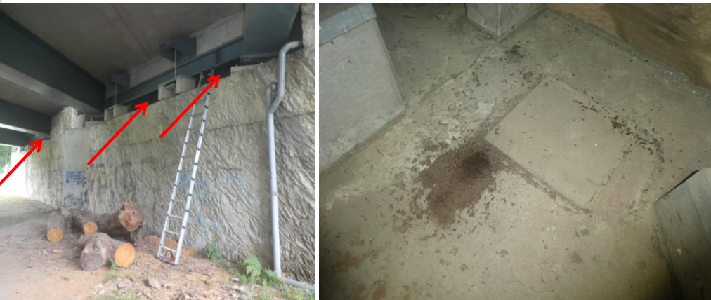
Espaces entre la culée et le tablier -- tas de guano au niveau de ces espaces (RD et RG)
