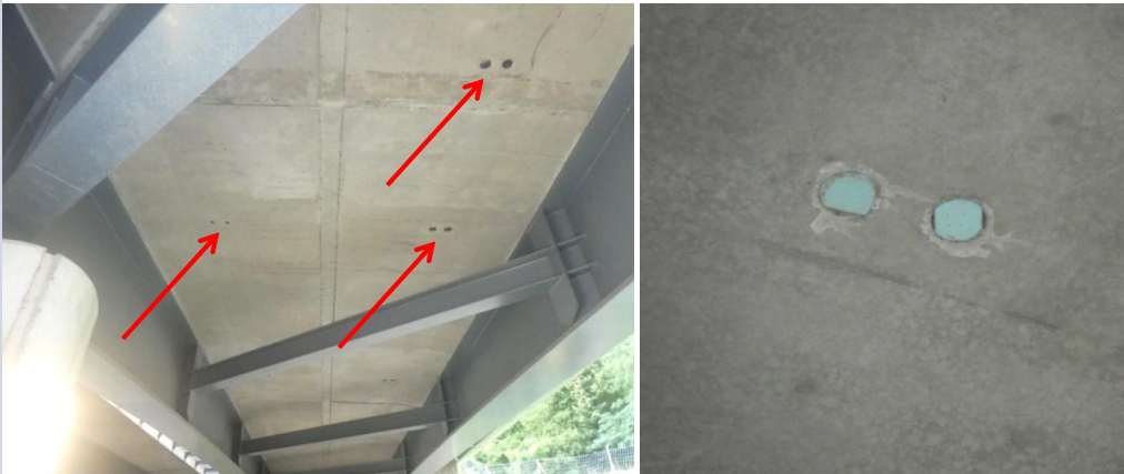
Anciennes réservations cylindriques partiellement obstruée -- certaines bouchées, inutilisables par les chauves-souris
