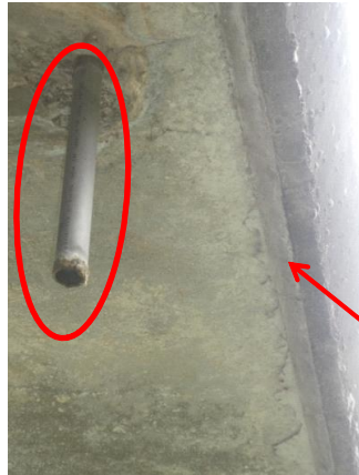
Drain très probablement inutilisable par les chauves-souris (car fonctionnel et dépassant largement de la maçonnerie) et corniche amont bétonnée
