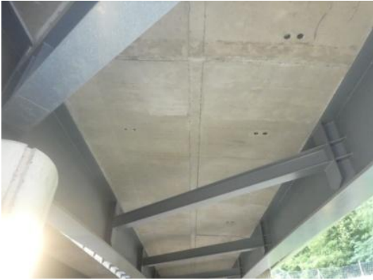
Anciennes réservations cylindriques (partiellement obstruées) – Pont de Viger (n°34)
