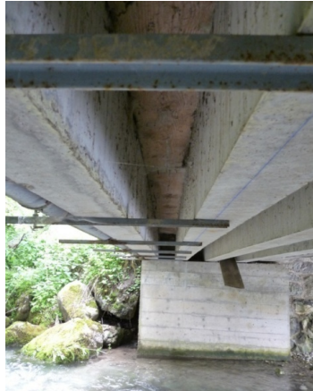
photo 21 : Une planche posée entre les poutrelles métalliques (et fixée) constituerait un nichoir de premier choix ! © Julien GIRARD-CLAUDON
