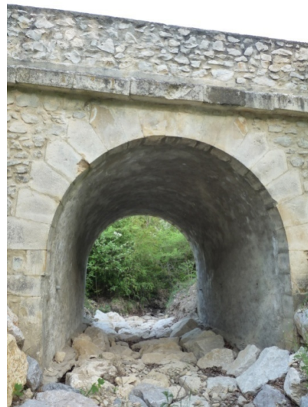
photo 12 : Ouvrage récemment rénové et ne comportant plus aucune cavité favorable aux chauves-souris © Julien GIRARD-CLAUDON
