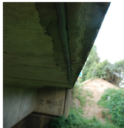
photo 19 : Cavité bouchée à l'aide de gaine d'isolation de tuyaux de chauffage © Sophie BAREILLE
