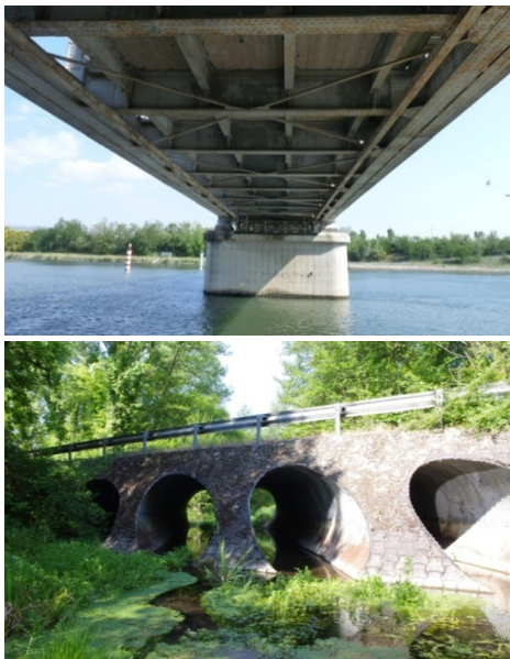
photo 11: Ponts à structure ou voûte métallique non favorable aux chauves-souris. © Julien GIRARD-CLAUDON et Julien CORNUT
