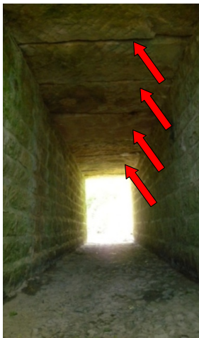
photo 5 : Disjointement entre les dalles © Julien CORNUT
