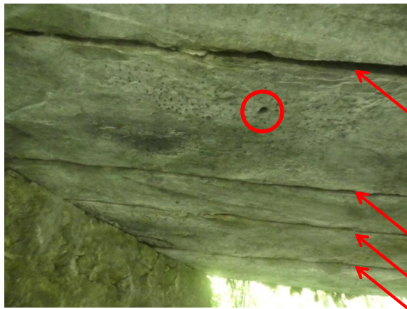
Espaces entre les dalles et illustration d'un des trois trous de barre à mine
