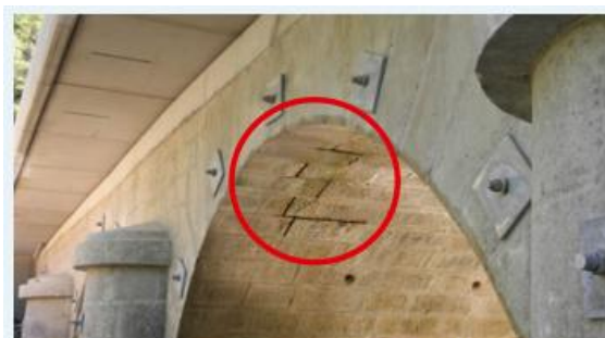
Photo 133 : Interstices non rejointés lors des opérations d'entretien de l'ouvrage (Source : CPEPESC Franche-Comté)
