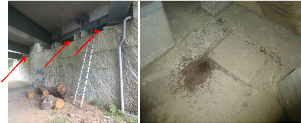
Espaces entre la culée et le tablier -- tas de guano au niveau de ces espaces (RD et RG)
