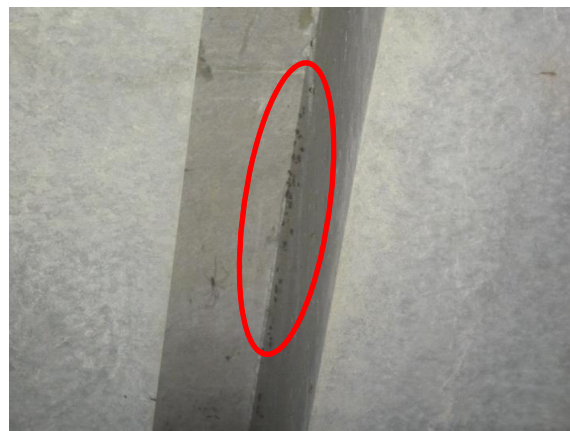
Guano accroché aux parois des poutres sous le tablier
