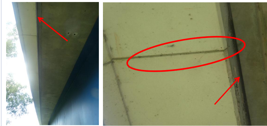
Espace dans la corniche, vu de dessous -- guano visible sur le rebord à l'aplomb de la corniche
